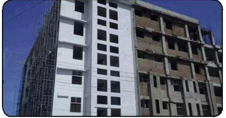
लेडी गोशेन अस्पताल, मंगलूर - एमआरपीएल के "आरोग्य संरक्षण" के तहत 5 मंज़िला ब्लॉक, नि.सा.उ. पहल का निर्माण कार्य प्रगति पर है.
